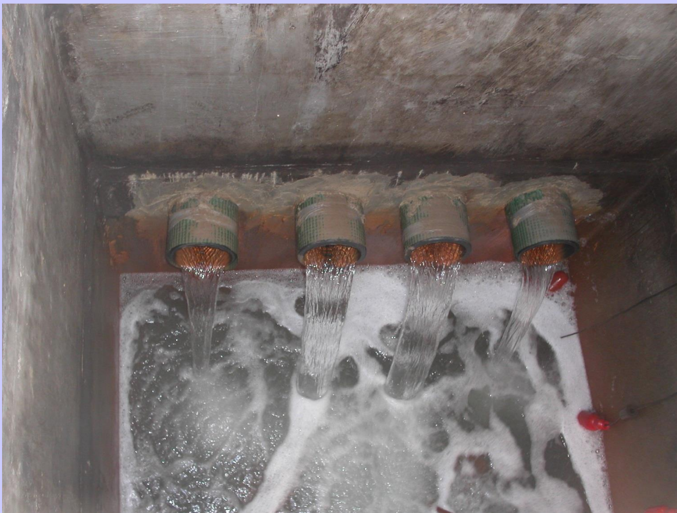
Tubazioni di sbocco all'interno della stazione di sollevamento.
